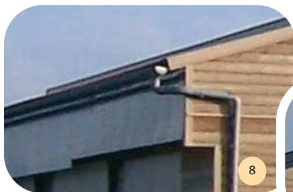
Sur les longs-pans, en haut des bardages en bois, des trappes protégées sont réglables manuellement.
