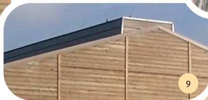
La ventilation en faîtage est assurée par un lanterneau mobile, isolé. Le réglage automatique (sonde) est effectué par un treuil en tête de bâtiment.
