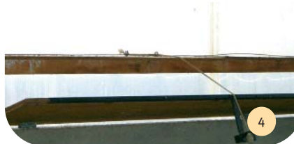
Un volet réglable est installé à l'intérieur, au-dessus des murs.
